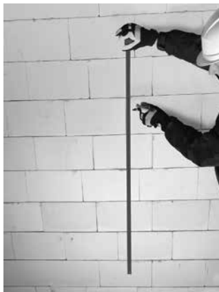
fot. 19 Na wyznaczonej trasie przebiegu pionu odmierzamy punkty montażu obejm oraz miejsca wykonania podejść do przyborów sanitarnych.
